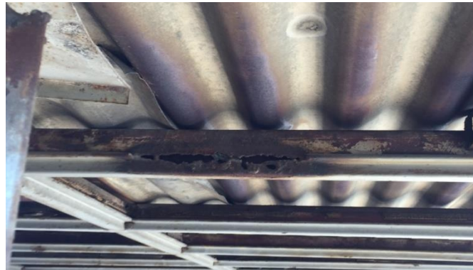
Şekil 1. Korozyon hasarının olduğu bir çelik kiriş
