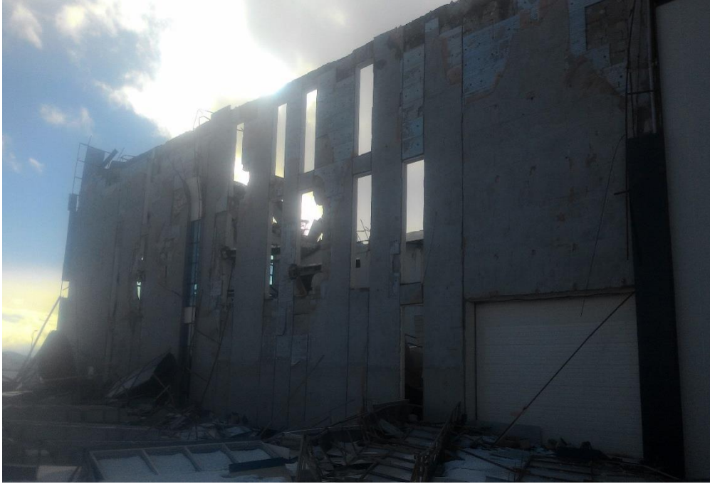
Şekil 8. Fuar Alanı-1 bölümü dış cephesinde oluşan hasar
