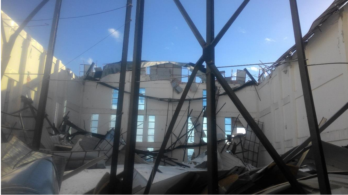
Şekil 7. Fuar Alanı-1 bölümü çatı ve çelik taşıyıcı sistemde oluşan çökme ve hasar
