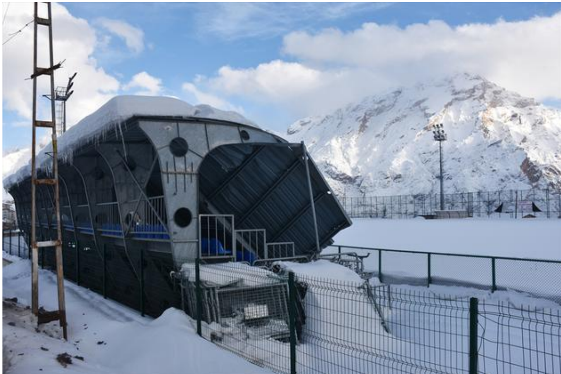
Şekil 3.Hakkari Şehir Stadinın göçen tribün çatısı [6]
