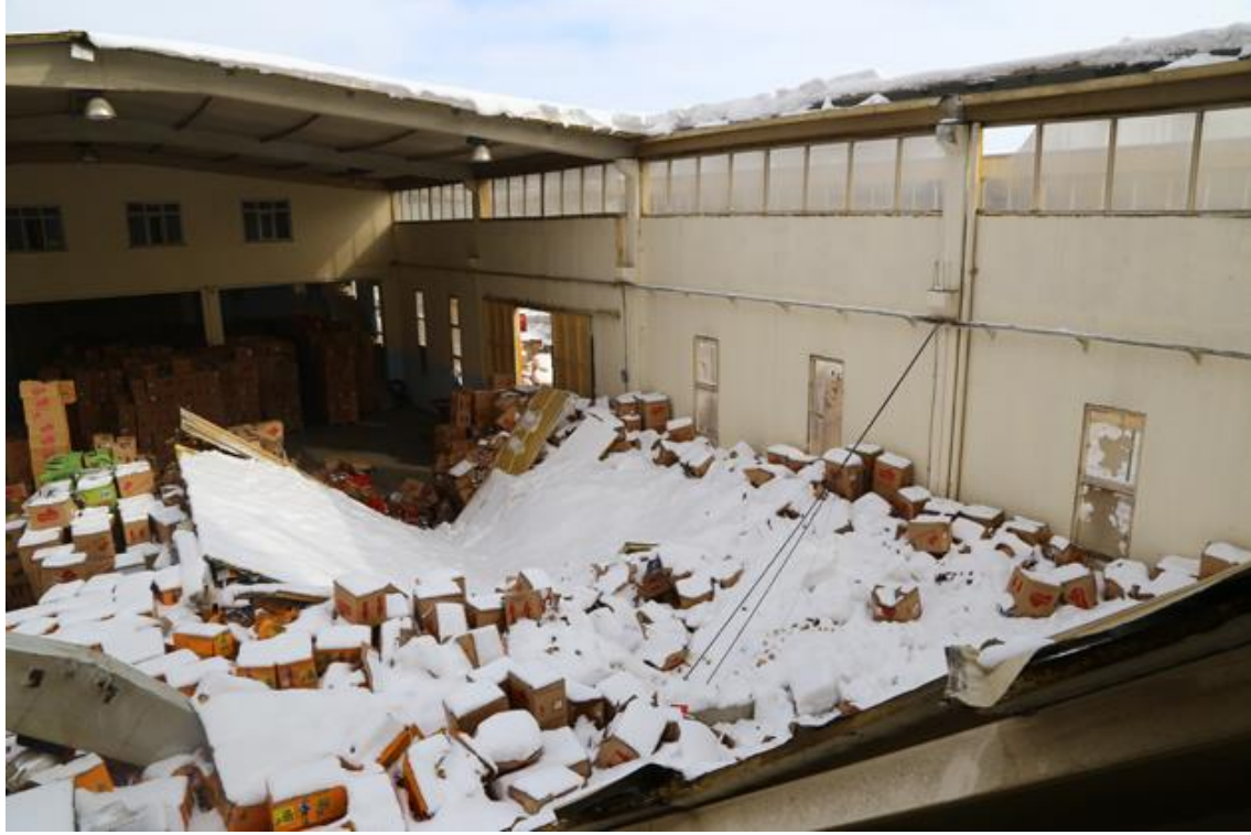
Şekil 4.Konsan Sanayi Sitesindeki çatısı göçen fabrikalardan bir tanesi [7]
