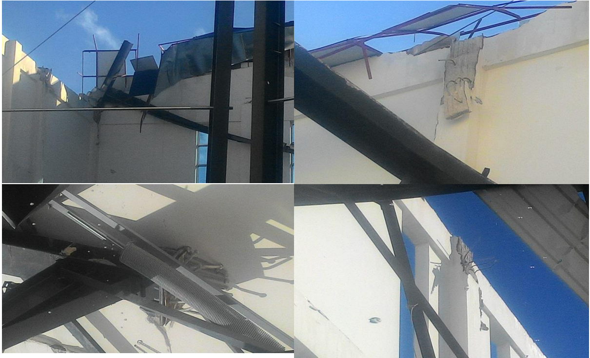
Şekil 10. Çelik Kolon alt ucundaki ankraj bulonunda meydana gelen sıyrılmaya ait resimler
