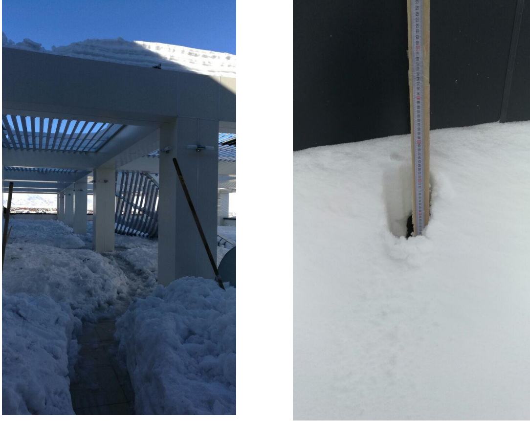
Şekil 11. Çökme olayının gerçekleştiği zamanda yapı mahallinde kar yüksekliği ile ilgili çekilmiş resimler
