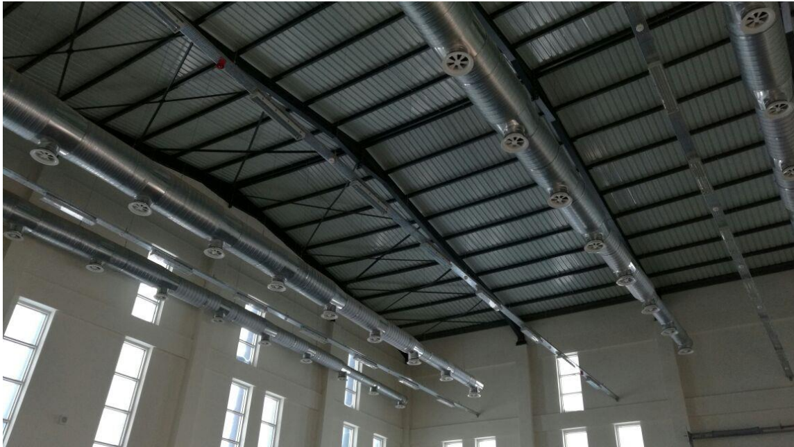
Şekil 9. Fuar Alanı-2 çatı kısmındaki rüzgar ve rijitlik bağlantılarında oluşan hasar
